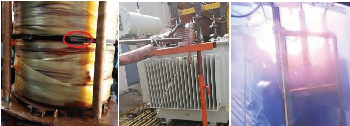
Рис. 26 Отказ из-за осевой силы рис.27 Утечка масла через бак Рис. 28 Возгорание на трансформаторе
