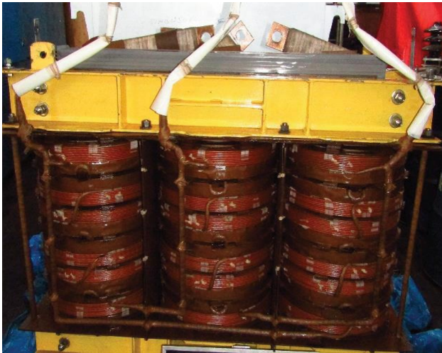
рис. 25 Обмотка трансформатора 630кВА
