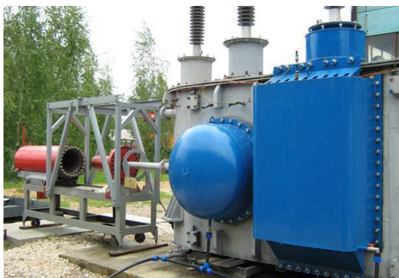
Рисунок 7 - Автотрансформатор с СДЗ перед испытаниями
