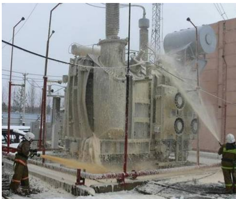
Рисунок 4 - Трансформатор на ПС в Западной Сибири после взрыва
