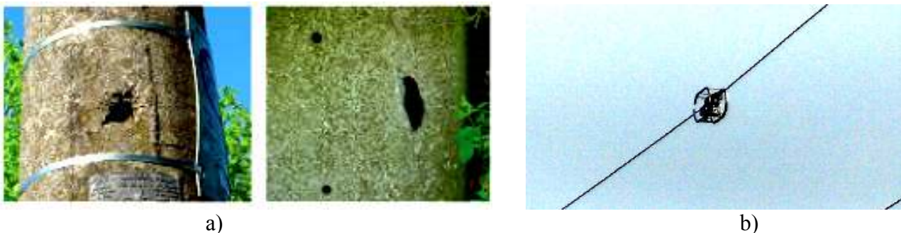
Рис. 10. Примеры из базы данных о состоянии ВЛ: а – деградация опор, б – контроль состояния цинкового покрытия сердечника АС провода
