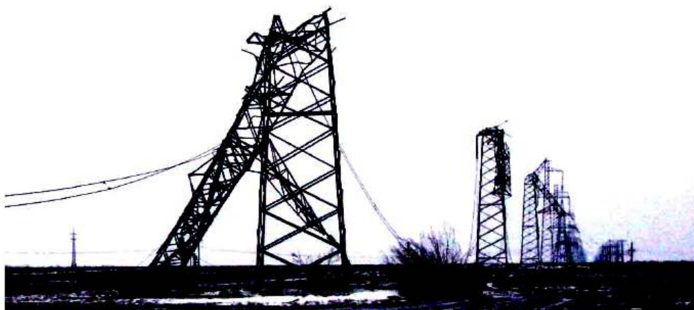
Рис.11. Повреждённая анкерная секция ВЛ 330 кВ «Каховская - Джанкой»
